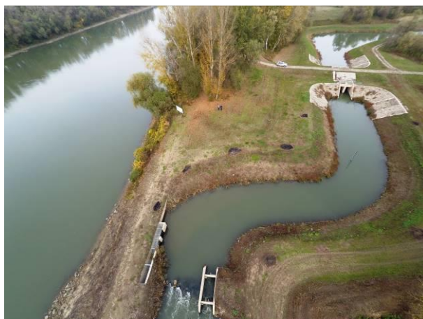
13. kép. A keresztező műtárgy feletti alsó pihenő tó és a torkolati szakaszra rávezető csatorna légi fotó képe
