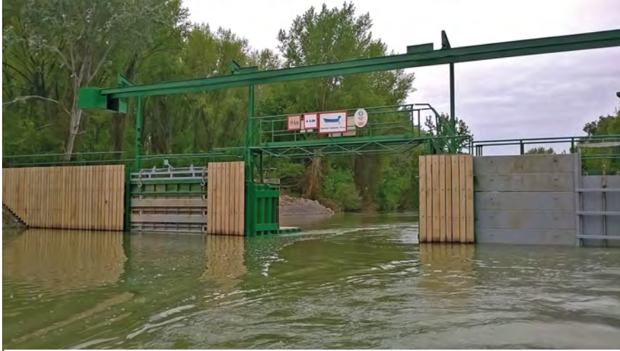
Öblítő csatorna szabályozó műtárggyal, nyitott állapotban
