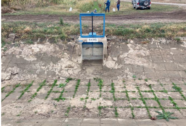
14. kép Tiszafüredi III-IV. összekötő mellékcsatorna 0+000 km tiltós áteresz
