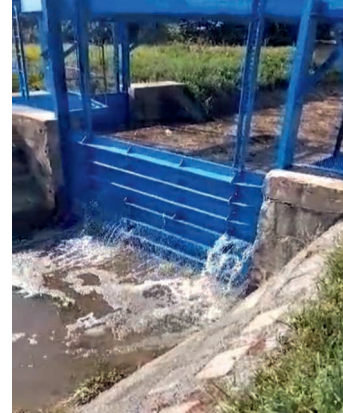
15. kép VI. zsilip nem zár tökéletesen, a lamellák között vízátfolyás van
