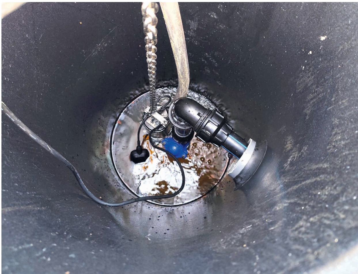
90. kép Szivattyú elhelyezése az oldómedencében
