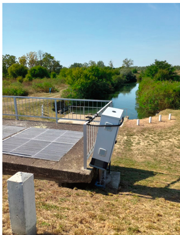
39. kép Jászsági-főcsatorna 18+070 szelvény Tiszasülyi vízleadó
