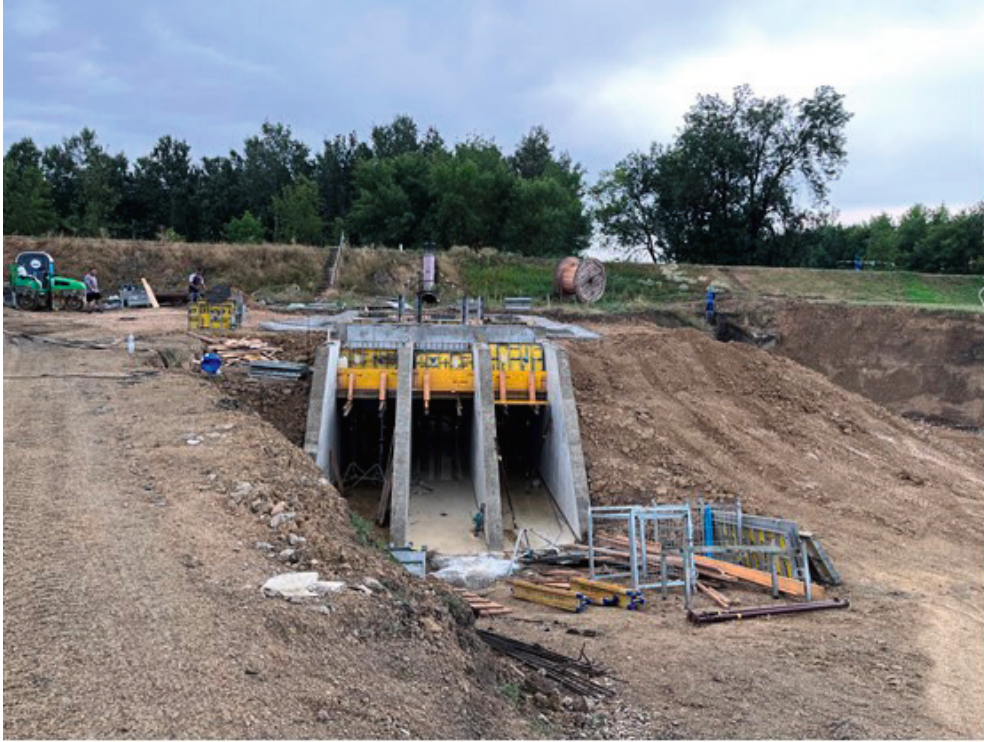
23. kép Gástyási reverzibilis szivattyútelep
