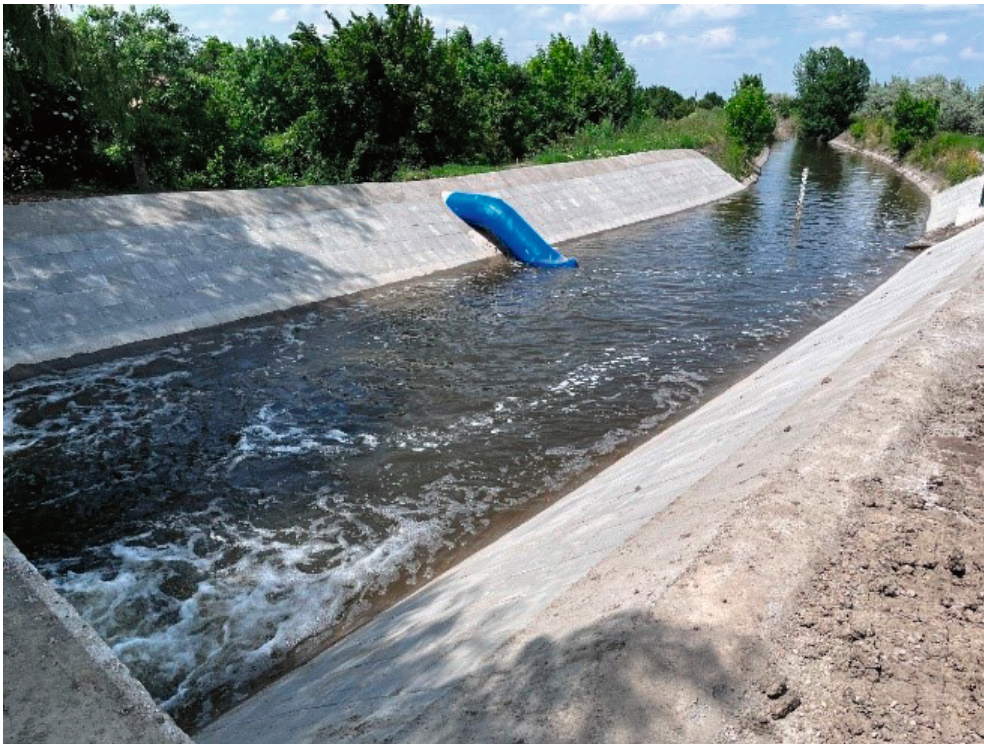
24. kép Gástyás I. öntözőcsatorna nyomócsővel
