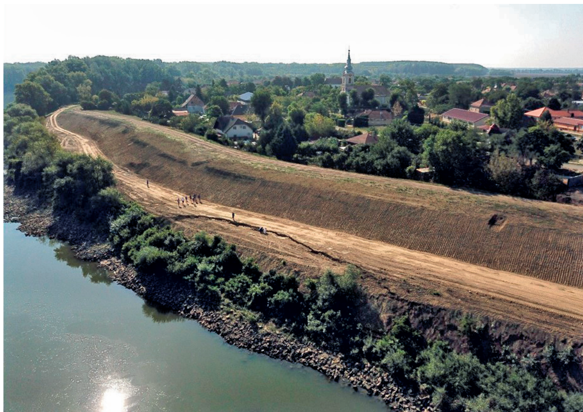
42. kép A földmunkákat követő karélyos megcsúszás
