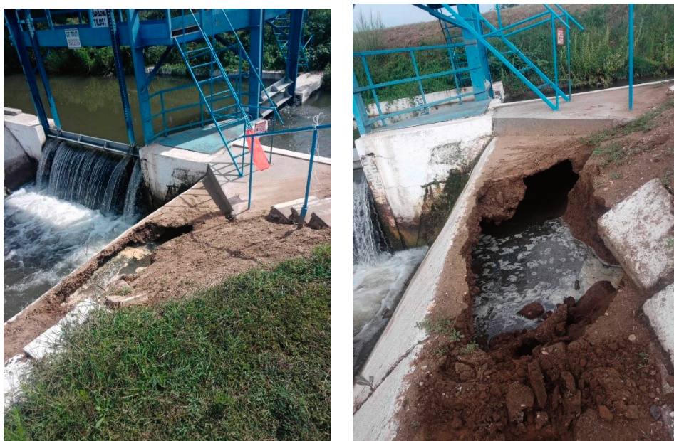
12. kép Tiszafüredi IV. mellécsatorna kiágazás alatti rézsű kimosódás
