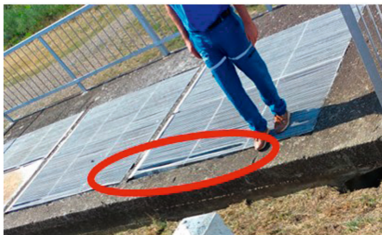
38. kép J.III-2 öntözőcsatorna beeresztő műtárgy rongálás
