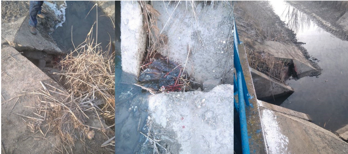
26. kép Nk X-2 csatorna a Harangzugi I-c csatorna keresztezésénél lévő bújtató műtárgy
