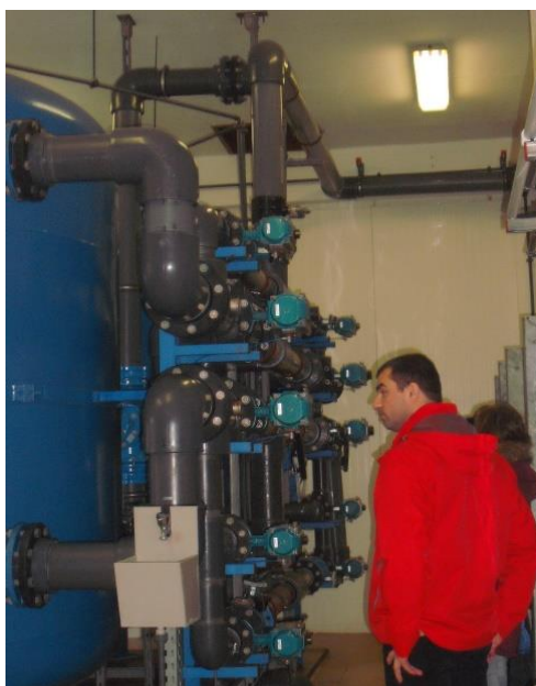
A 2008-ban átadott sarudi vízműtelep
