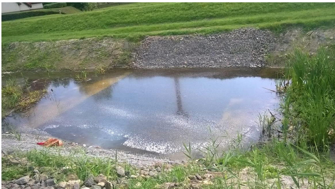
Kőröstej Kft. csapadékvíz-bevezetési hely
