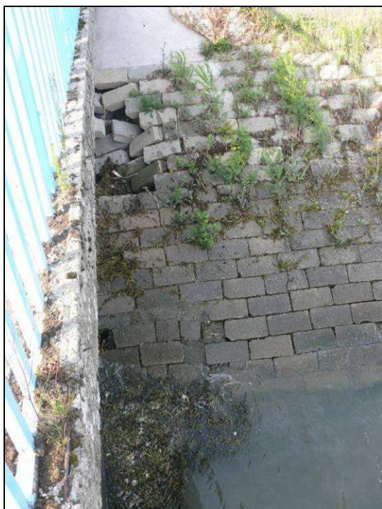
5. fotó. Nkfc. felvízi oldalán beszakadt burkolat
