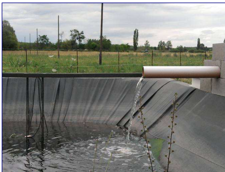
18. fotó. A technológiából kikerülő tisztított víz
