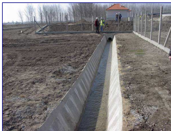
17. fotó. Betonozott tisztítottvíz-elvező csatorna
