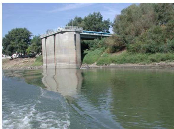
9-39. ábra: Szolnok város felszíni vízkivételi mű
