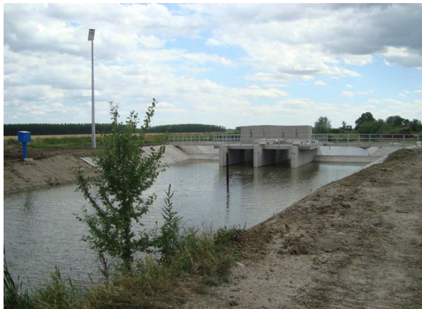
5-28. ábra: Milléri belvízfőcsatorna (3+700 km szelvény) műtárgy a fejlesztés után
